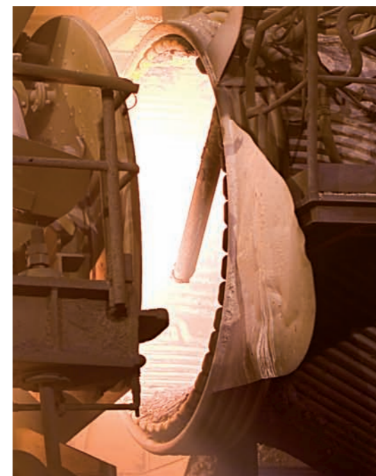
Die Abgassonde des EFSOP-Systems im Dampfkanal
